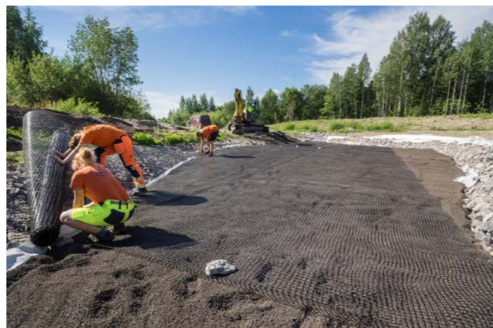
Nuove strutture di gestione delle acque piovane. Area di Ranta-Kartano forniscono anche una piattaforma per la ricerca e lo sviluppo.
